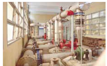
Bên trong nhà máy xử lý nước
