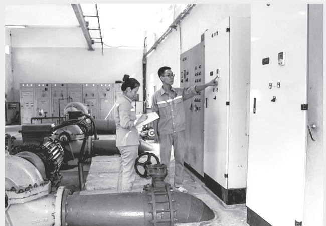
Hệ thống các thiết bị bơm và điều khiển bên trong nhà máy
