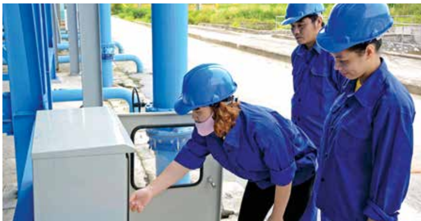
Nhà máy nước sạch Tri Phương (Tiên Du) đạt công suất thiết kế 17.500 m 3 /ngày, từng bước đáp ứng nhu cầu sử dụng nước sạch của người dân
